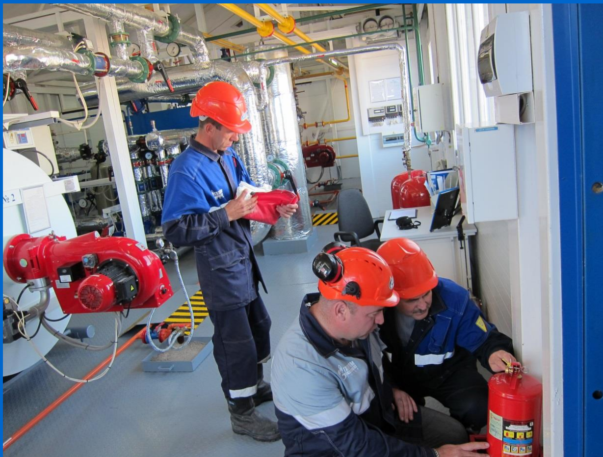
Осмотр первичных средств пожаротушения в помещении котельной №1 Томской промплощадки
