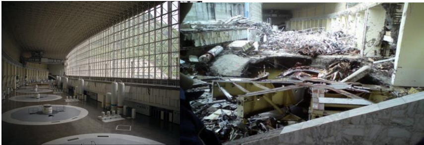
2009 Саяно-Шушенская ГЭС (РусГидро)
